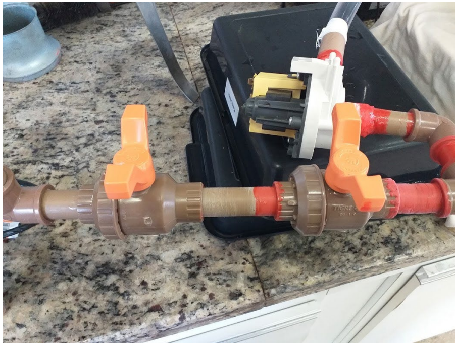
Figura 6 – Válvulas para o controle de circulação
