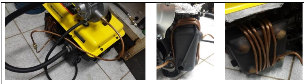
Figura 11. Tubulação de cobre e espiras no motogerador
